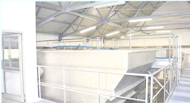
Wnętrze stacji uzdatniania wody „Jasieńczyk”
